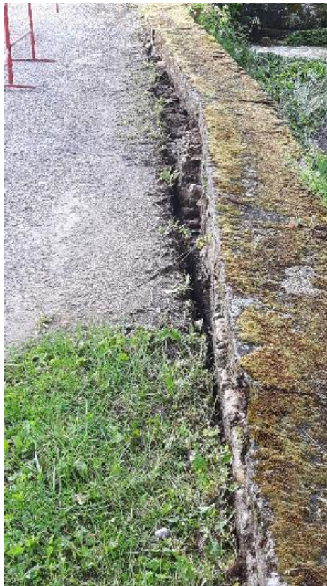
Photo 5 : incision entre la route et le muret du pont.
