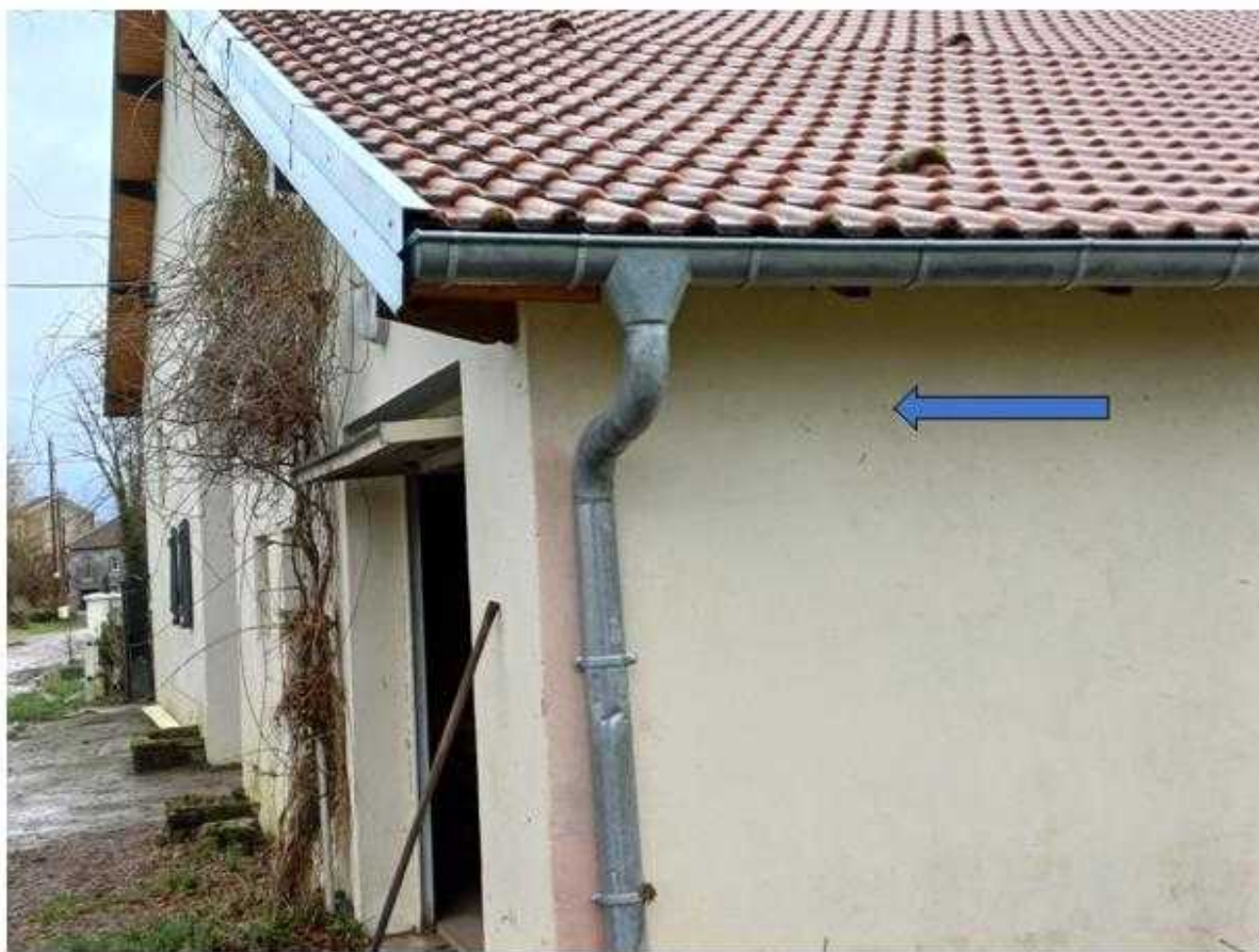
Sur cette maison, la flèche bleue indique le niveau de la crue relevé à 1.80 mètres.
